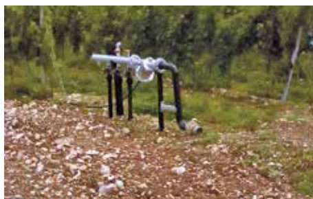
Impianto pluvirriguo ad opera Consorzio Bonifica Brenta(2018) € 10.000 contributo Comune più pagamento quote dei privati
