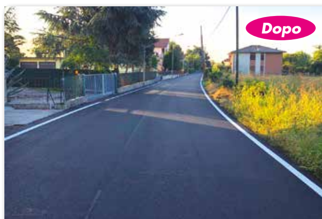
Manto stradale di via Maglio
